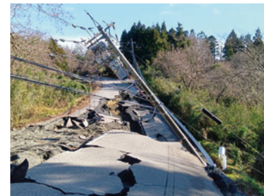
電柱傾斜(道路損壊)
