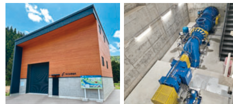
別又谷発電所建屋と水車・発電機
