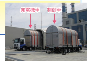
常設代替交流電源設備
