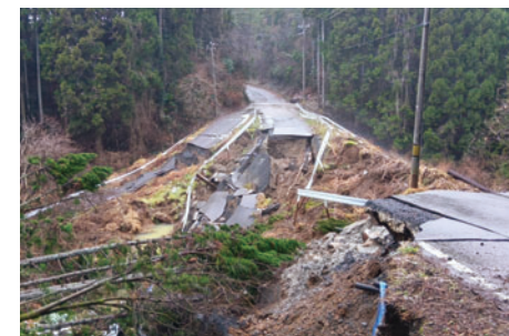
道路崩落(寸断)
