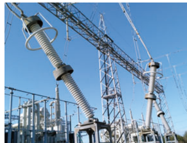
275kV 避雷器破損
