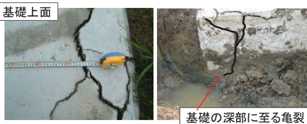
第1図 基礎に生じた亀裂の例
