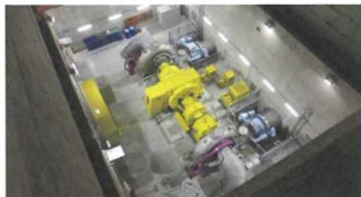
八ッ場発電所 群馬県企業局
